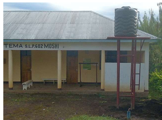
診療所に設置された給水タンク
